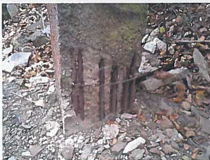
Poruchy v patě sloupů vnitřních podpěr
