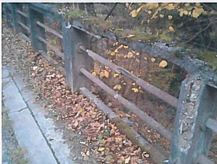
Uspořádání na římse, poruchy zábradlí
