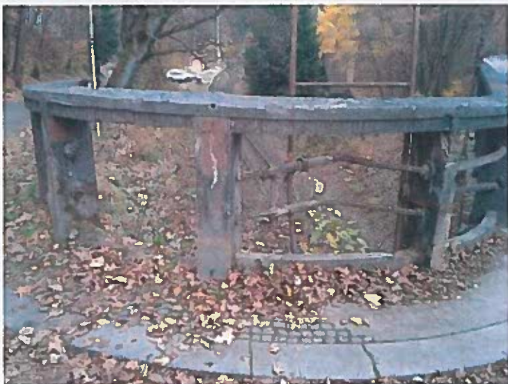
Uspořádání na římse, poruchy zábradlí, nánosy vegetace
