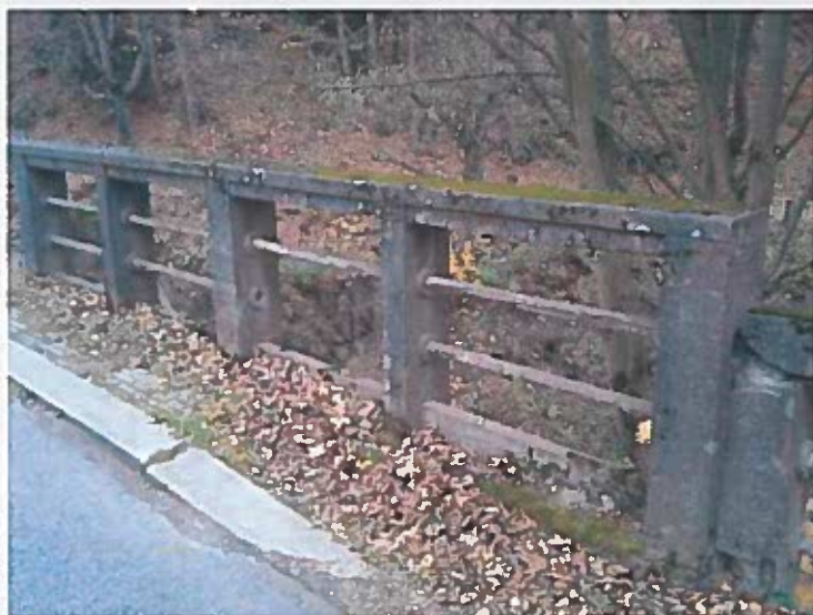
Uspořádání na římse, poruchy zábradlí, nánosy vegetace
