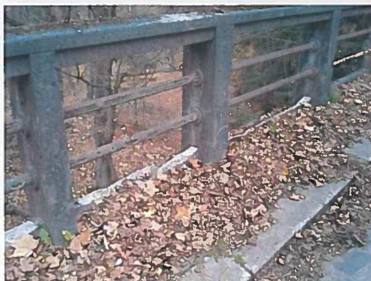
Uspořádání na římse, poruchy zábradlí, nánosy vegetace
