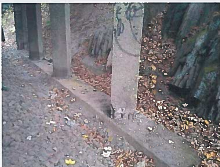
Poruchy v patě sloupů vnitřních podpěr
