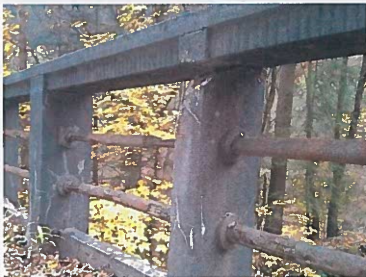
Uspořádání na římse, poruchy zábradlí, nánosy vegetace
